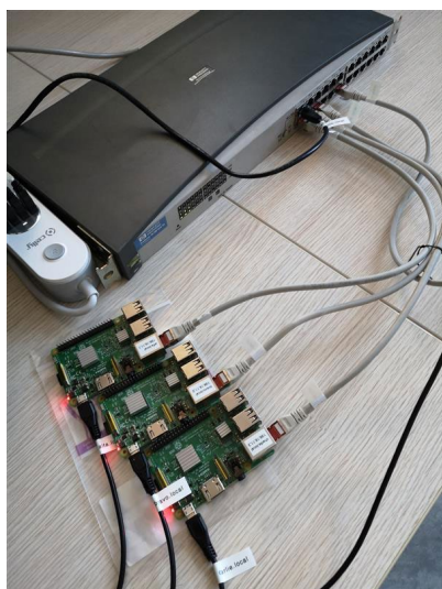
Figura 1 – Alcune delle componenti hardware parte della rete implementata
